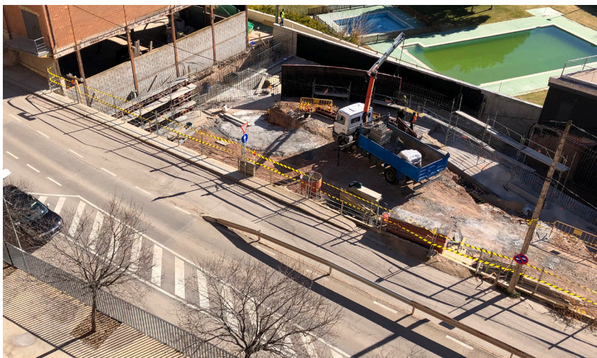
Les obres van avançant i ja es comença a intuir part de la nova rotonda
